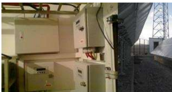
شکل ۵) پیاده سازی سیستم Off-Grid یک سایت BTS جاده‌ای در انار تزرچ کرمان
